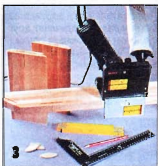
3 Пользуясь фрезерной машинкой, выбирают пазы под шпонки, обеспечивающие прочные и надежные соединения деталей.
