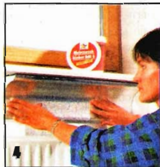
При утеплении угла между стеной и подоконником крепят на клею и фасонный пенопластовый профиль.
